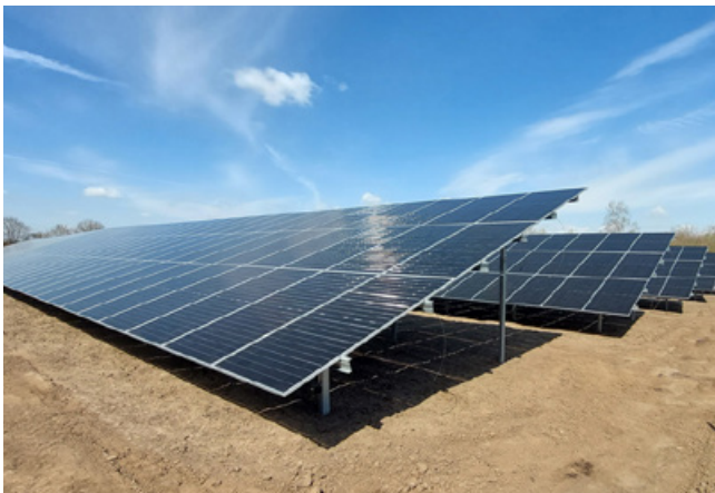
PV-Poing | 1,0 MWp | In Betrieb seit November 2025
