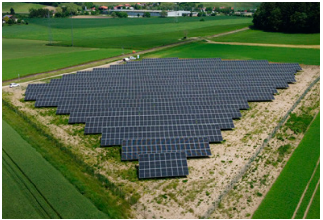
PV-Oberlauring | 1,5 MWp | In Betrieb seit Juni 2024
