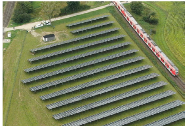
PV-Haus | 1,5 MWp | In Betrieb seit Oktober 2021
